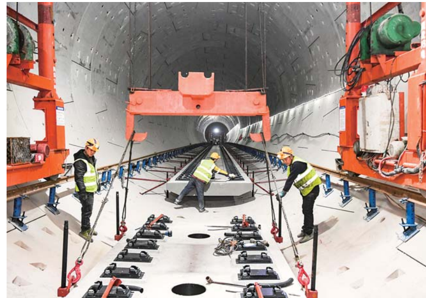
12月5日，中铁二十四局施工人员在重庆轨道交通15号线二期工程物流园北站至井口站区间隧道进行铺轨作业。
