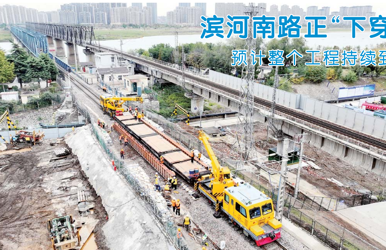
11月18日,滨河南路下穿京沪铁路立交工程现场,工程技术人员在施工前对现场进行测量。
