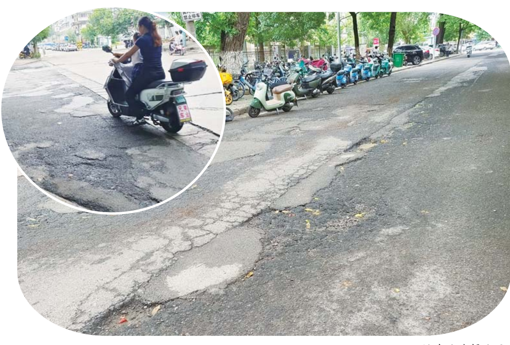
沿淮路破损路面。
