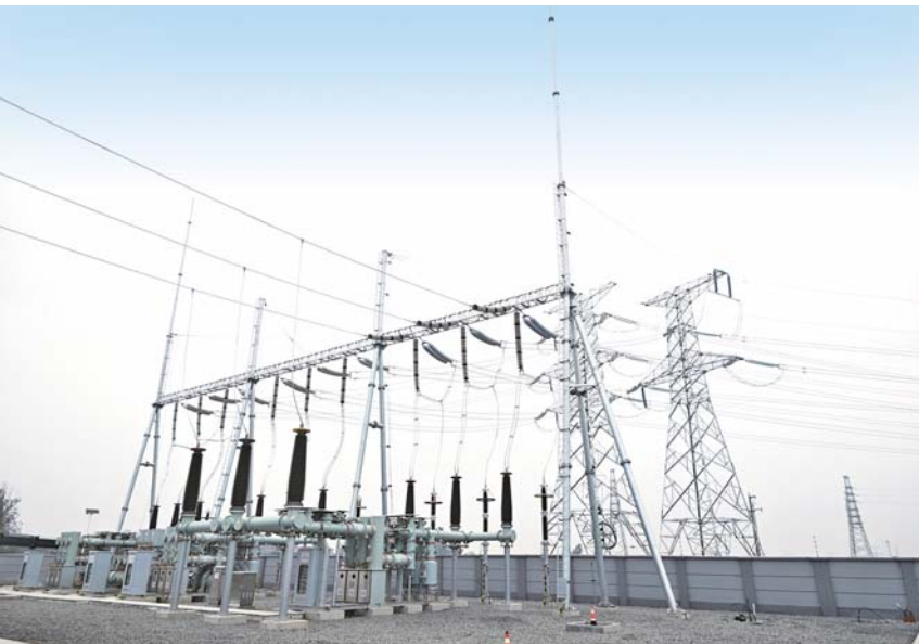
五河县林洋五河风光储一体化基地项目现场。
