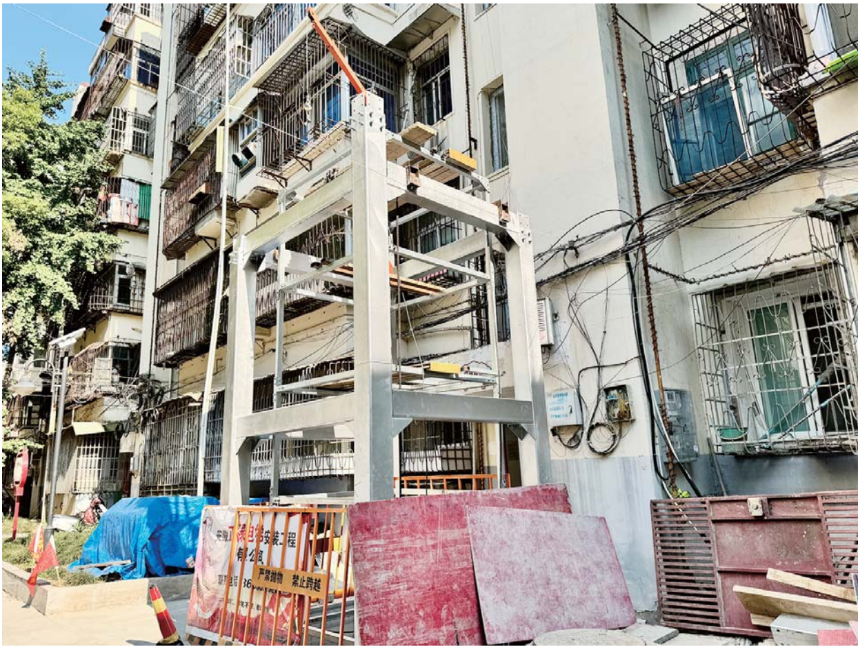
喻义巷社区第一个既有住宅整体装配式加装电梯正在施工。
