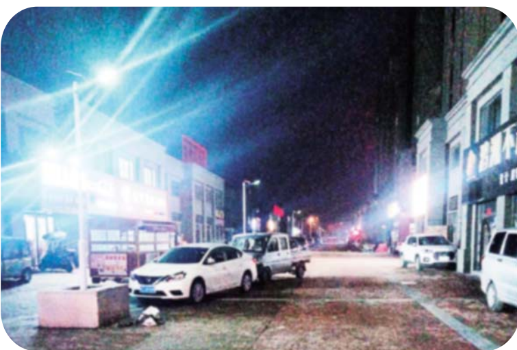
绿地迎宾城一、二期商业街内安装好的太阳能高杆路灯。
