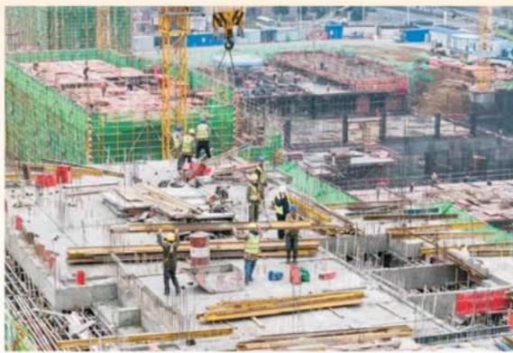
在李楼乡蚌蚌高铁新村安置房项目施工现场，塔吊林立，工人正在加紧施工作业。
