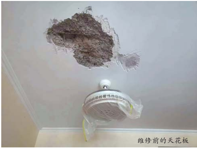
维修前的天花板
