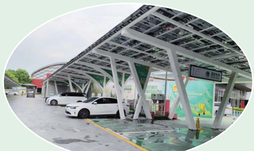
淮河文化广场全要素低碳新型电力系统示范区汽车充电站。
