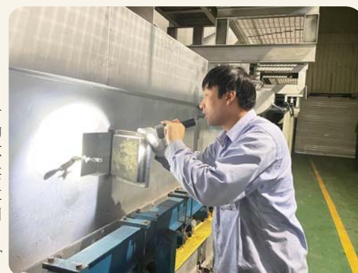
安少颖巡查检修设备。
