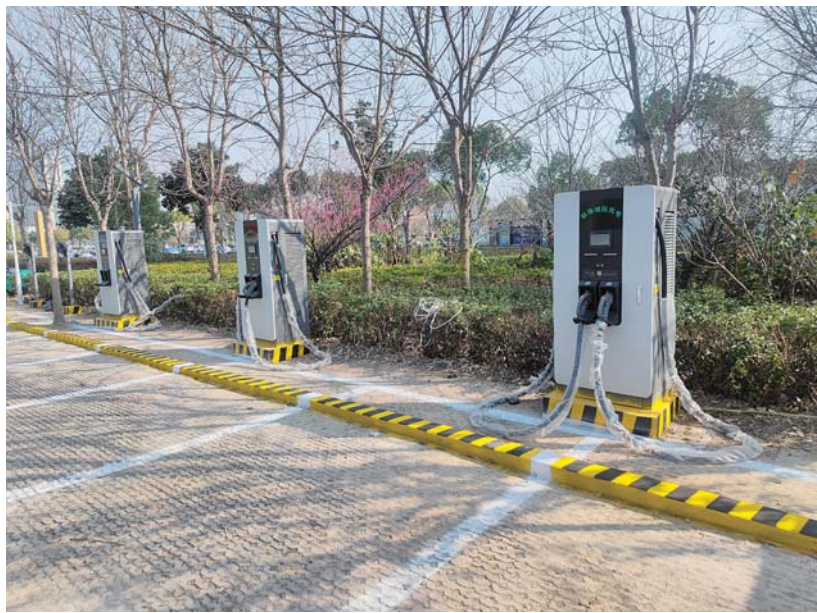
东海大道张公湖桥东绿地停车场充电桩
