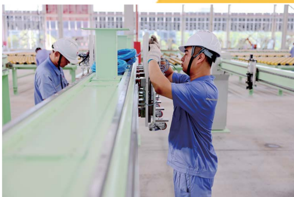
7月8日,蚌埠凯盛工程技术有限公司员工安装调试设备,汗水浸湿了工作服。
