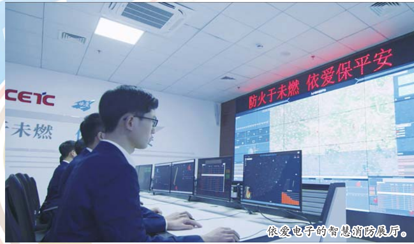
依爱电子的智慧消防展厅。
