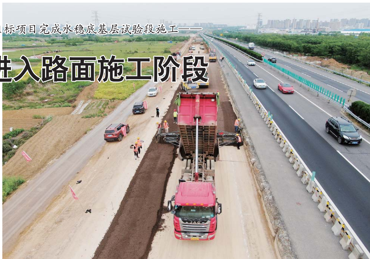
G36宁洛高速明蚌改扩建01标项目完成水稳底基层试验段施工。
