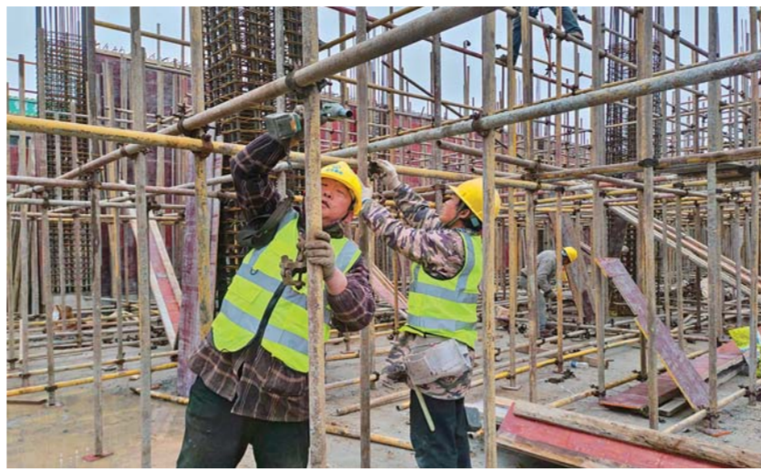
县医疗健康中心(一期)建设工地现场,工人加紧施工抢进度。
