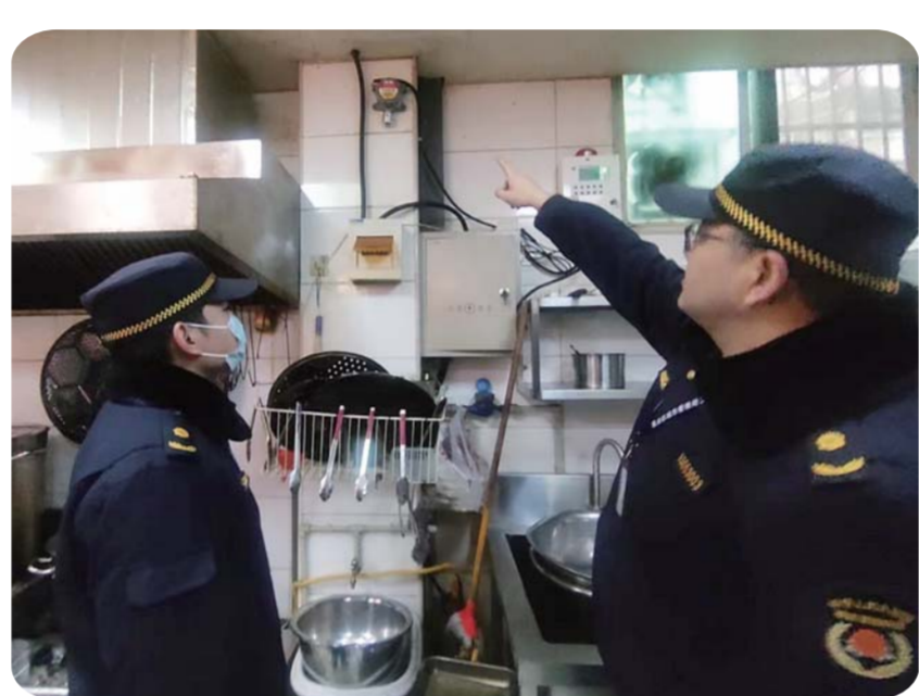
城管执法人员在商户内检查可燃气体报警器安装情况。
