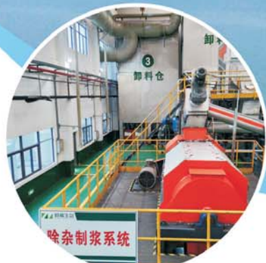
进行厨余垃圾除杂制浆。
